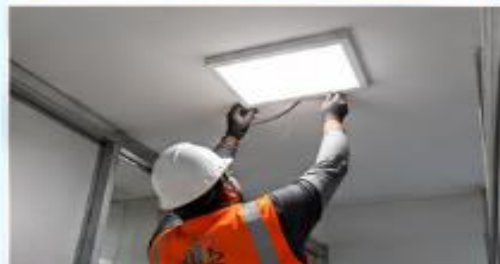
INSTALACIONES ELÉCTRICAS Y LUMINARIAS
